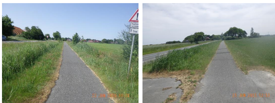
Abb. 48 L 5; Radverkehrsanlage mit Sanierungsbedarf
